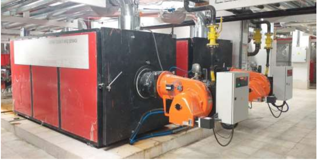
Kazanların doğalgaz tesisatını gösteren görseller
