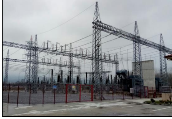
Görsel 2. 26. Şalt tesisi
